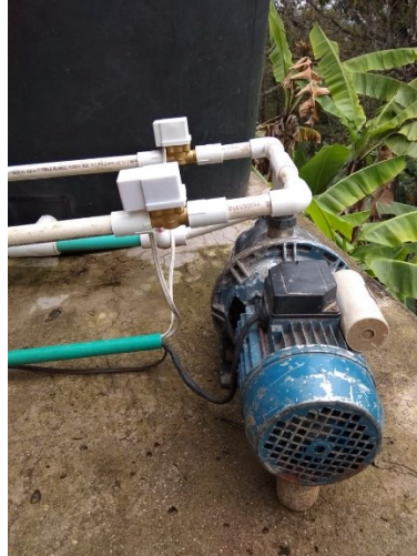
Imagen 31. Bomba con Electroválvulas de Salida
