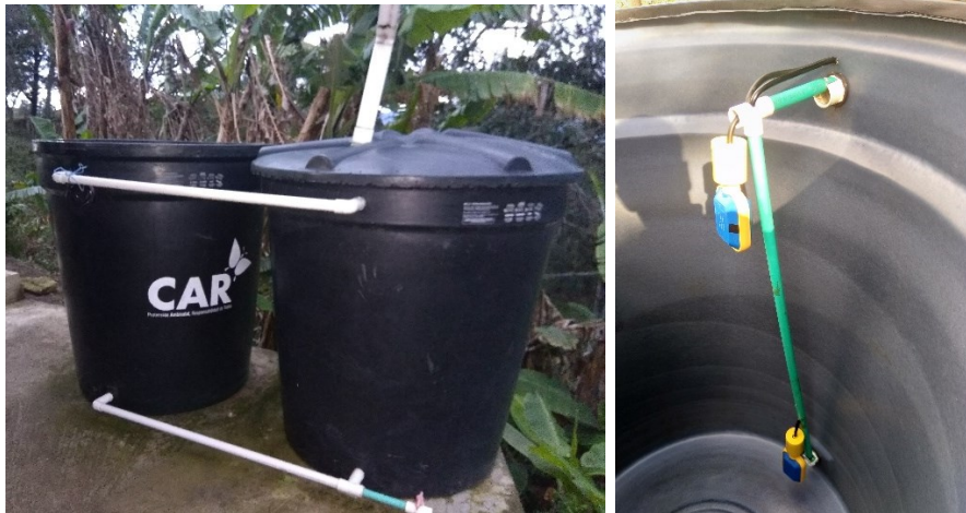
Imagen 29. Tanques de Almacenamiento y Flotadores
