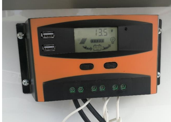
Figura 22. Controlador del sistema fotovoltaico (Elaboración propia).
