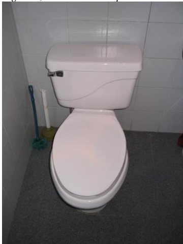
Figura 9, Sanitario sin dispositivo ahorrador
