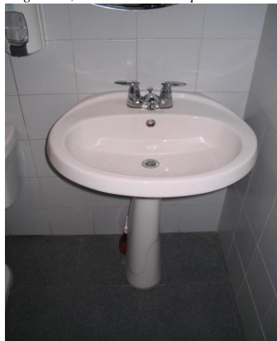
Figura 10, Lavamanos sin dispositivo ahorrador
