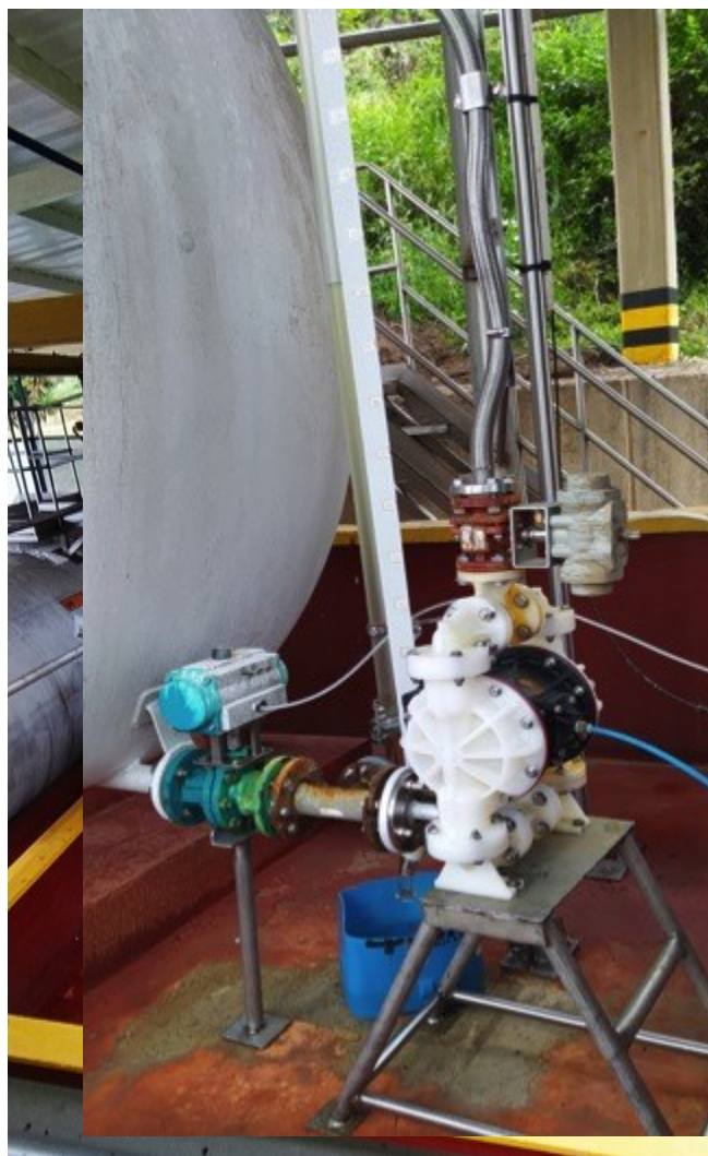
Fotografía No. 5. Un tanque de almacenamiento dentro de su dique de contención. Fotografía No. 6. Detalle línea de tubería y bomba de trasiego a la sonda de un tanque de almacenamiento. Fuente: Indumil Fexar
